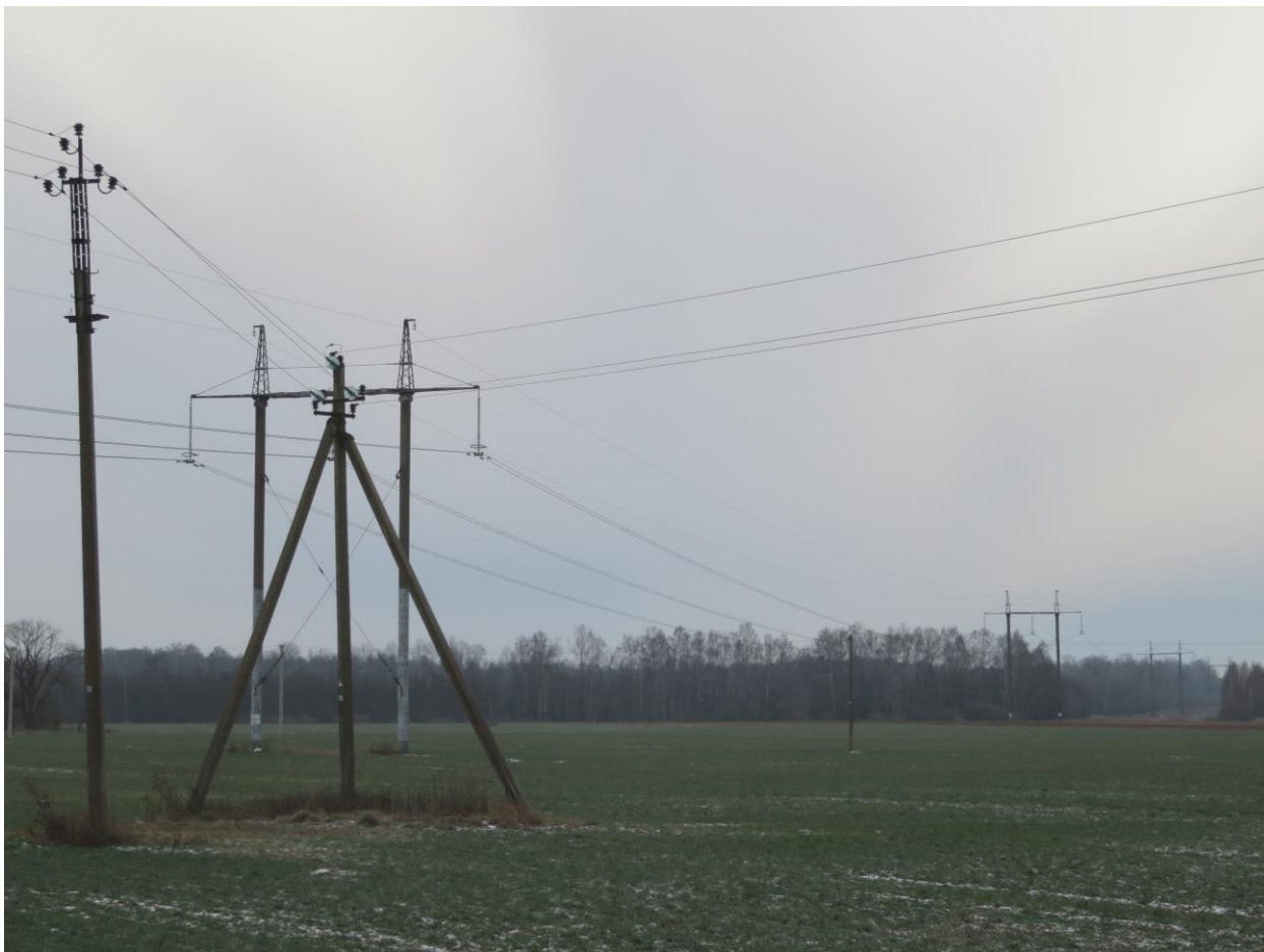
4 pav. Planuojamų VE teritorijos gretimybėje esama orinė 330 kV elektros perdavimo linija
